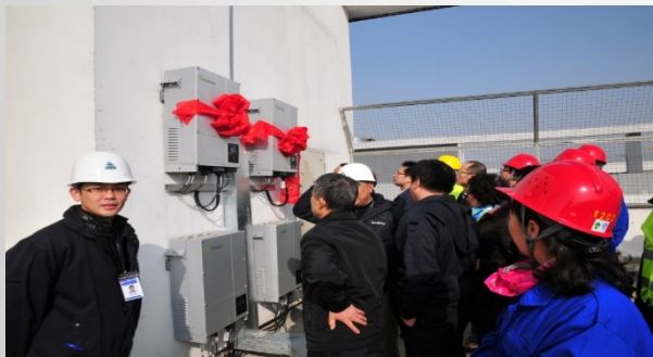
富士康集團20MW屋頂光伏發電專案 (金太陽)
