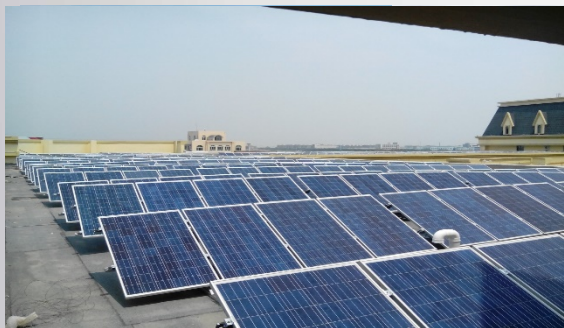
瀋陽金都40MW光電建築一體化發電專案
