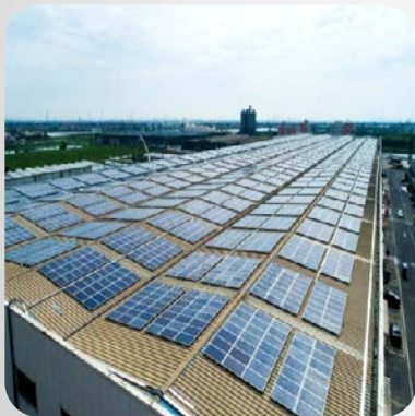
工商業屋頂電站
